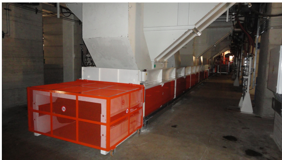
Scarico sfridi linea centralizzata
